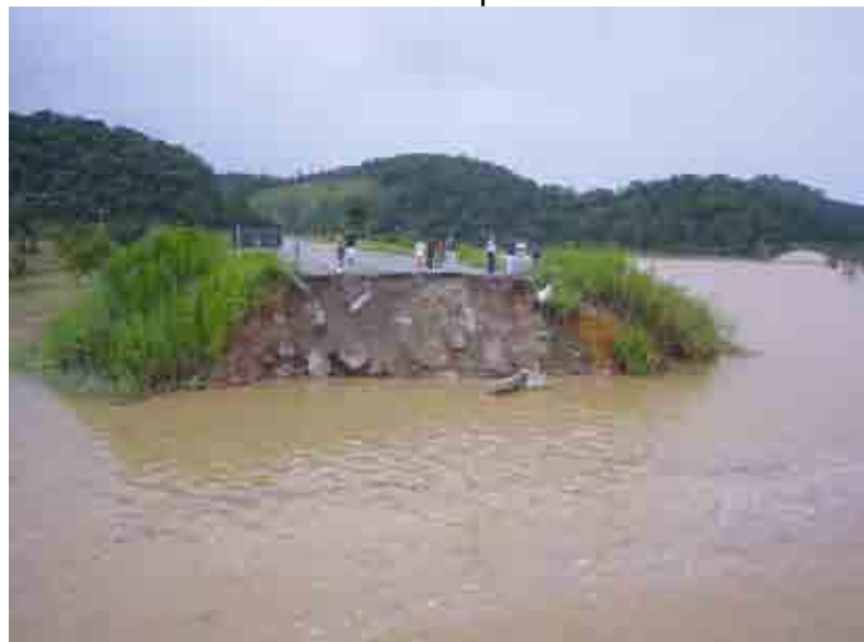
Figura 2.47 – Trecho da BR-101 sobre canal do São João após desmoronamento .
