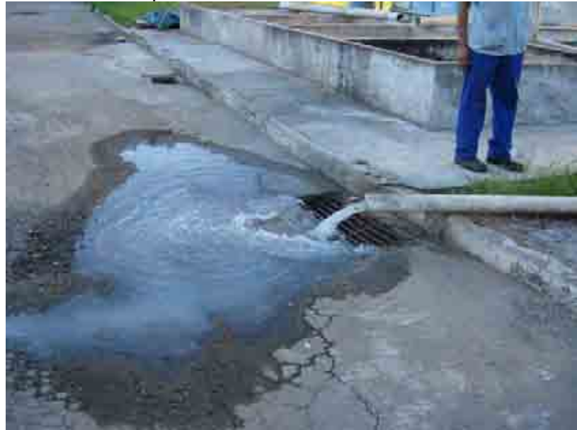
Figura 2.60 – Lançamento de efluentes industriais sem tratamento adequado
