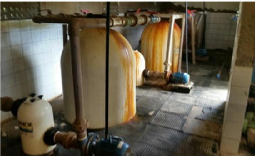
Foto 3 – Vista dos filtros, bombas e tubulações.
