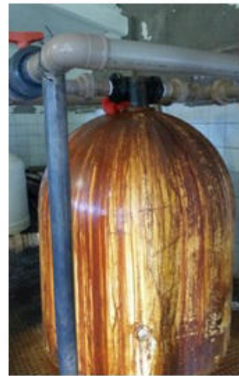
Foto 2 – Detalhe do filtro
