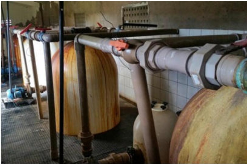
Foto 1 – Vista dos filtros e tubulações.
