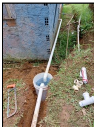
Foto 5 - Caixa de gordura.
