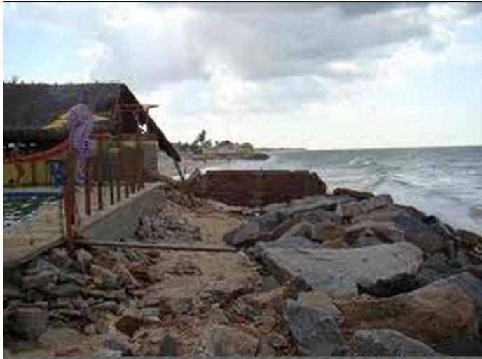
Fotos dos Danos nas Barracas de Praia – Praia de Icaraí
