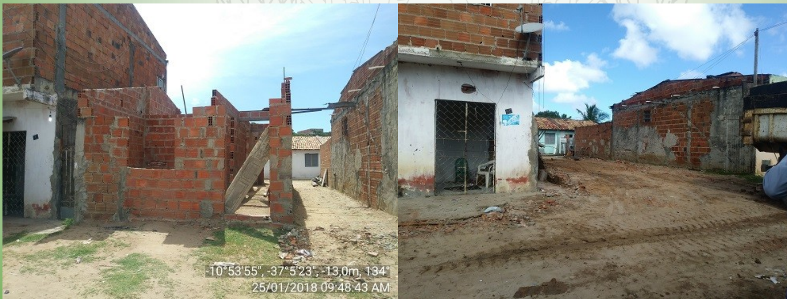
Figura 07 – Imóvel em fase de construção demolido na localidade Riacho do Cabral, Aracaju-SE.
