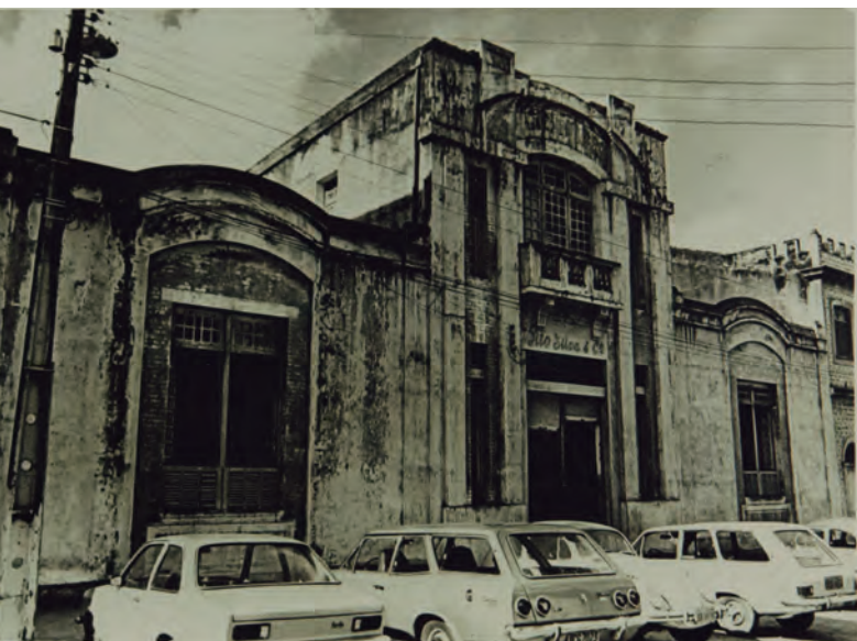
Fachada da Fábrica Tito Silva, João Pessoa, Paraíba. Maria do Carmo Buarque de Holanda, sem data. Acervo do Arquivo Central do Instituto do Patrimônio Histórico e Artístico Nacional.
