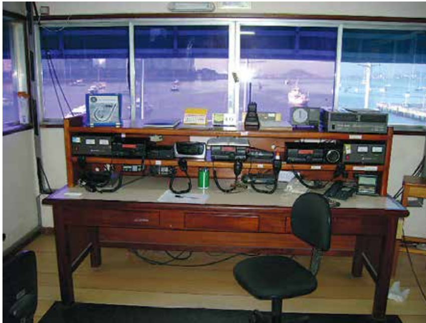
Figura 72: Estação de radiocomunicação
