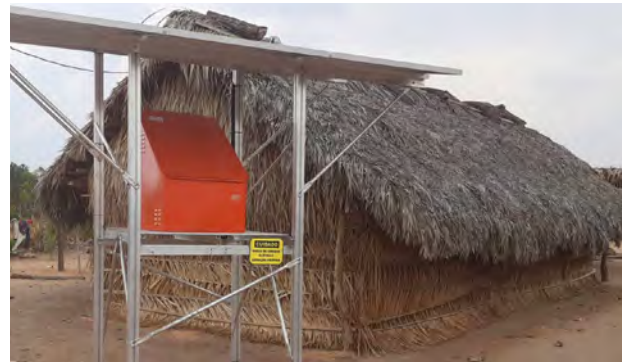
Sistema de energia solar
