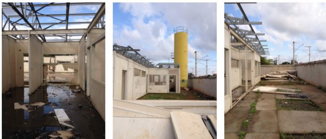
EMEI ID 24609 (Mato Grande) – Obra paralisada – Materiais expostos ao tempo
