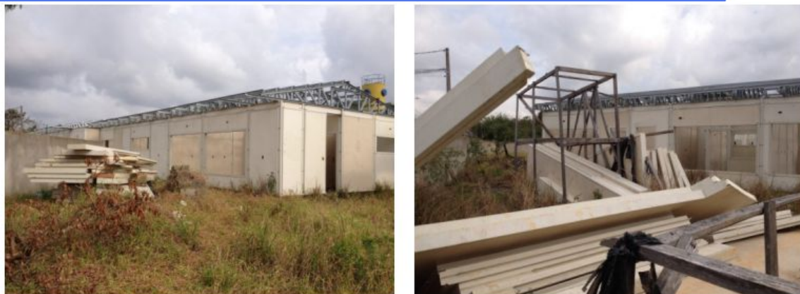
EMEI ID 24612 (Central Park) – Obra paralisada – Materiais expostos ao tempo
