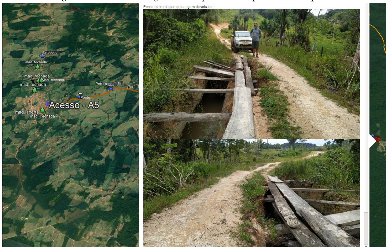
Figura 15. Acesso 5 - Passagem interrompida devido a precariedade de pontes.
