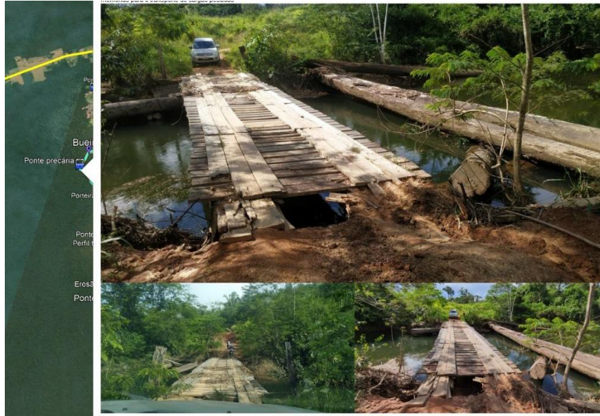
Figura 7. Acesso 1 - Exemplo de ponte inadequada.
