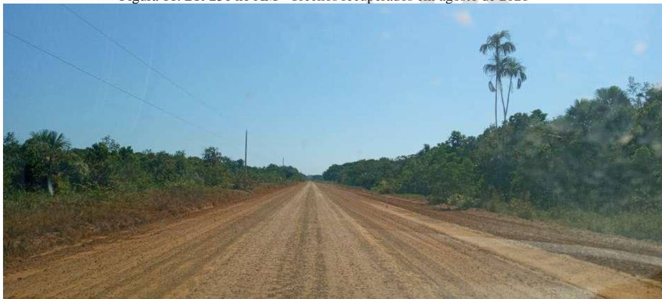
Figura 11. BR-230 no AM - Trechos recuperados em agosto de 2021
