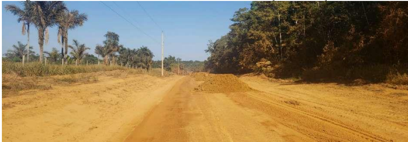
Figura 10. BR-230 no AM - Trecho da Transamazônica sob manutenção e recolocação de cascalho
