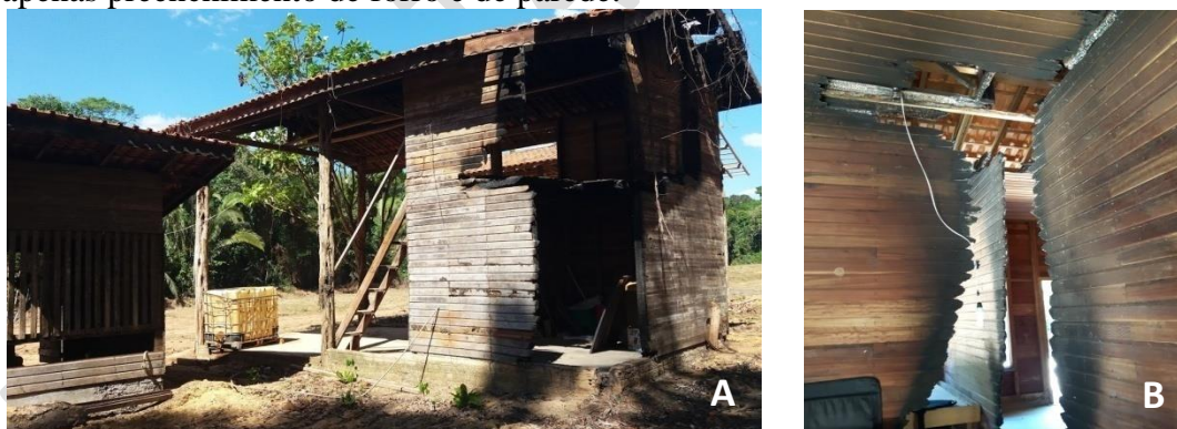
Figura 8 - Instalações após ação de vandalismo: (A) - Dano estrutural no fundos da oficina; (B) - Dano de no interior dos dormitórios, sem dano estrutural do prédio, apenas preenchimento de forro e de parede.
