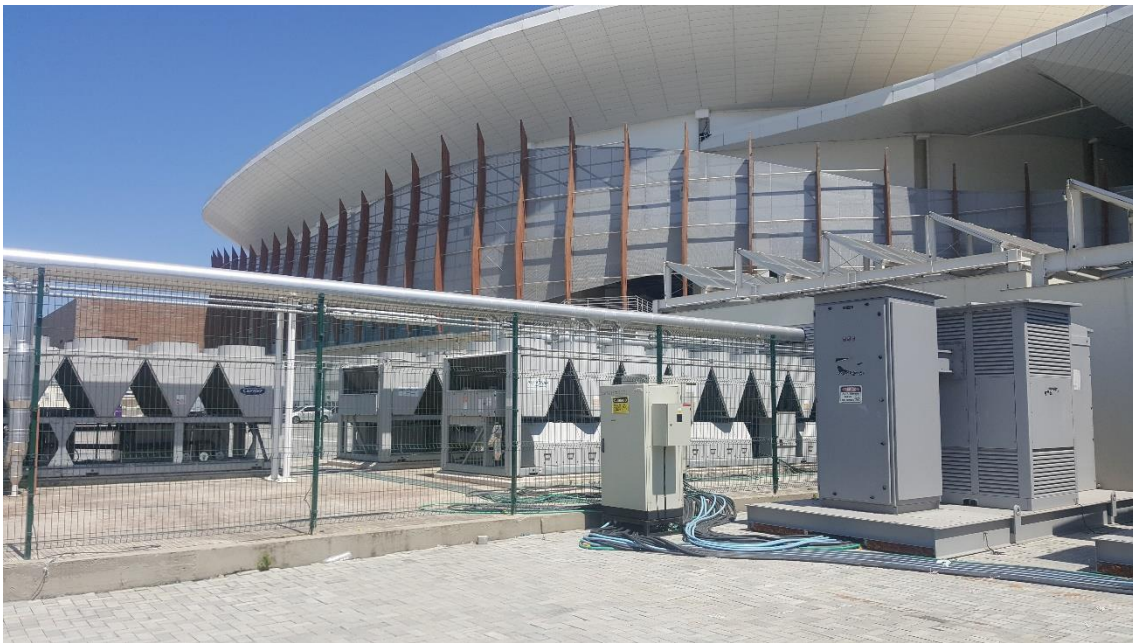
Foto - Arena Carioca 1: Centrais de Água Gelada e Eletrocentros, Rio de Janeiro 21 de setembro de 2017.
