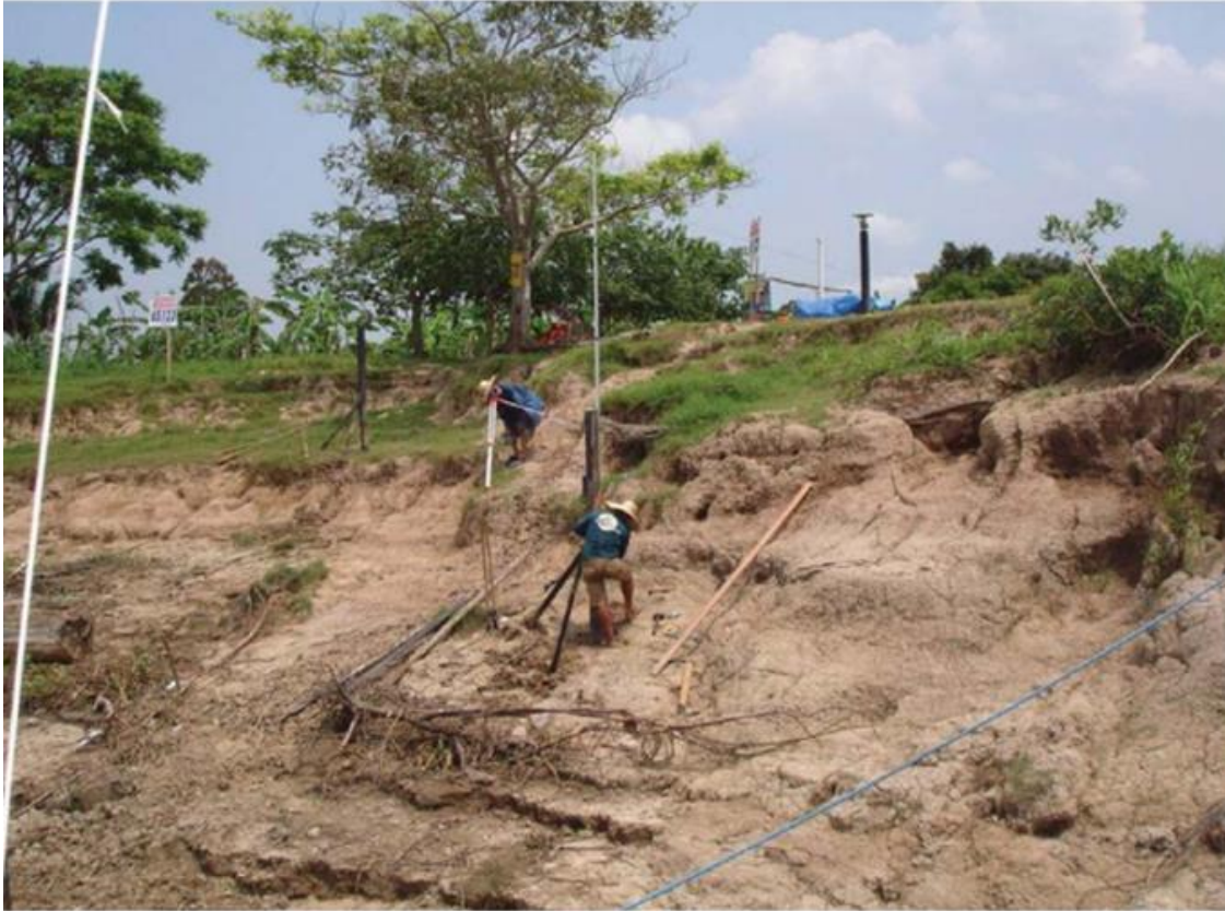
Figura 13 - Forte erosão que afeta as seções de réguas linimétricas e o nivelamento geométrico.
