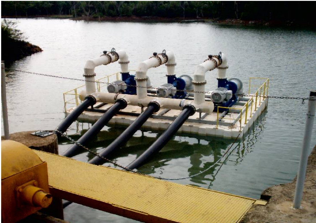
Foto 11 – Bombas de recalque. Projeto de irrigação Platôs de Guadalupe-MA.
