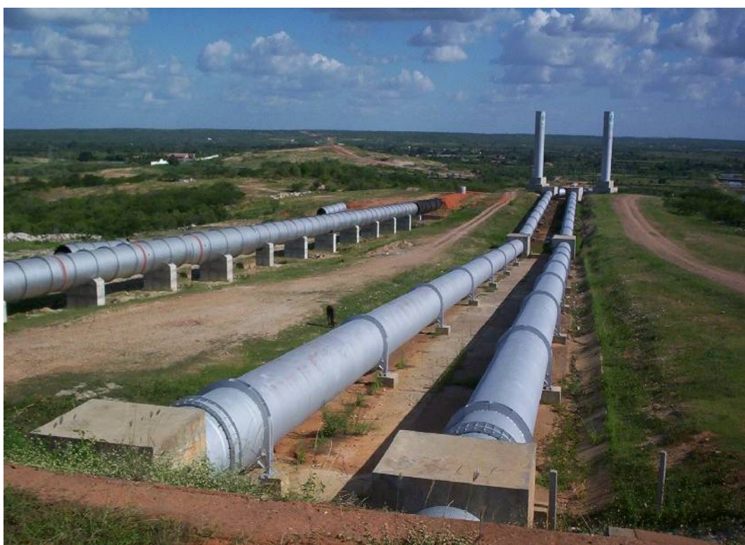
Foto 10 – Tubulação de recalque. Projeto de irrigação Tabuleiros de Russas-CE. À esquerda, a tubulação do canal de integração Castanhão à região metropolitana de Fortaleza.
