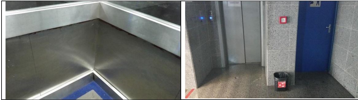
Foto – Elevadores do edifício sede da Administração Central do DNOCS, Fortaleza (CE), 30 de abril de 2015.
