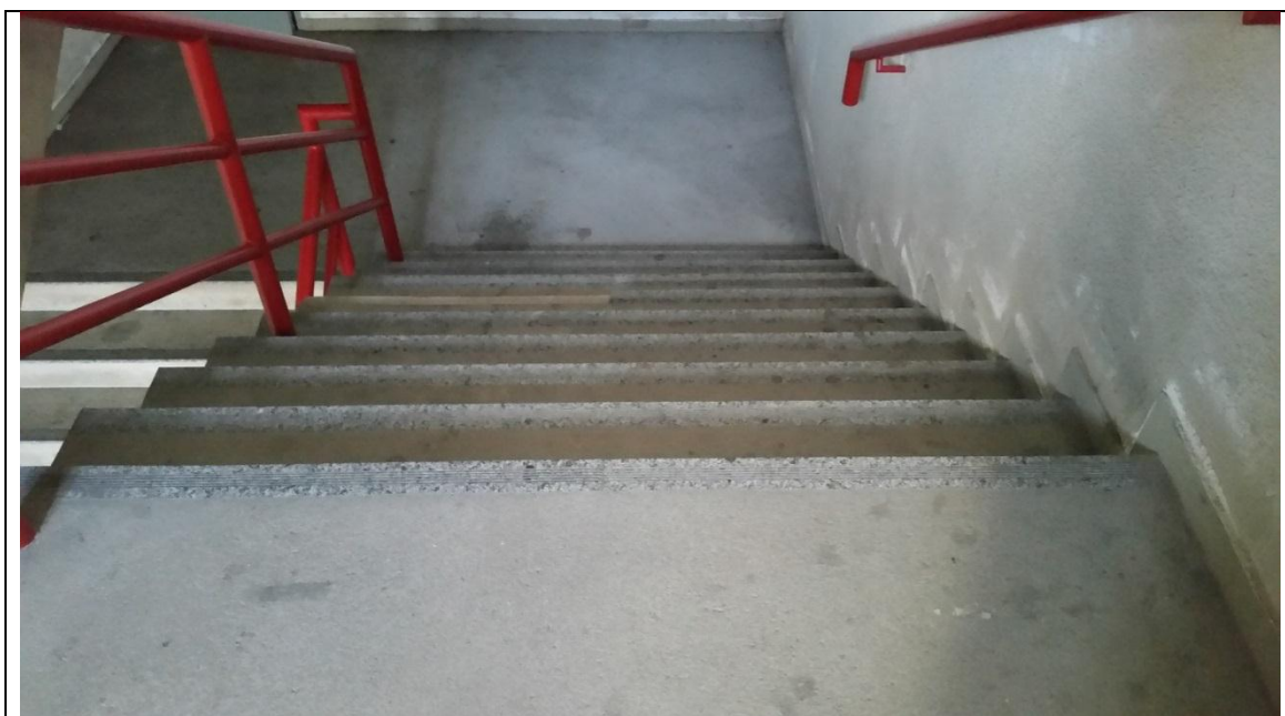
Foto – Escada do edifício sede da Administração Central do DNOCS, Fortaleza (CE), 30 de abril de 2015.
