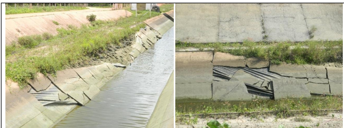
Fotos de canais danificados no Perímetro do Baixo Acaraú. Acaraú(CE), 04/09/2014.
