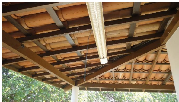
Foto 06 – Vista de trecho de cobertura da edificação, mostrando que a fiação elétrica já foi furtada. Apodi/RN – 09/06/2016.
