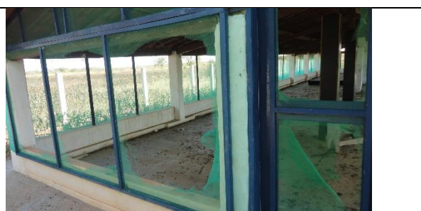
Foto 10 – Vista da fachada frontal do refeitório, mostrando que a tela de proteção contra insetos, apresenta-se com trechos destruídos. Apodi/RN – 09/06/2016.
