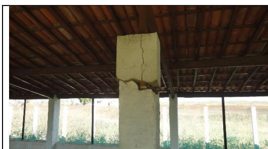
Foto 09 – Vista de um dos pilares do refeitório, mostrando que o mesmo apresenta fissuras longitudinais e trecho em ruínas. Apodi/RN – 09/06/2016.
