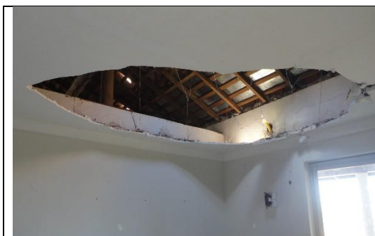
Foto 07 – Vista do forro de gesso interno do prédio da administração, mostrando que parte do mesmo foi destruída. Apodi/RN – 09/06/2016.
