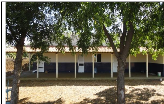
Foto 05 – Vista geral da fachada frontal do prédio da administração, mostrando que grande parte das esquadrias se encontra destruída. Apodi/RN – 09/06/2016.
