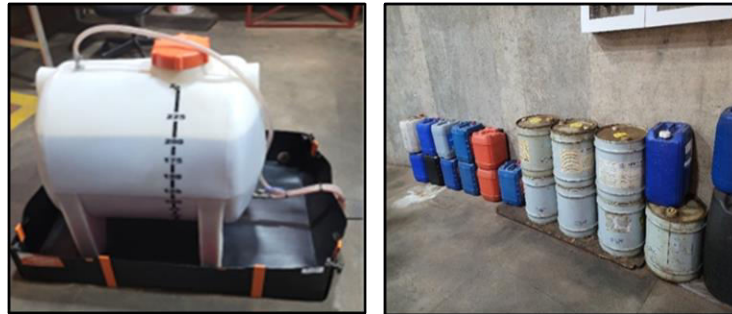
Figura 22: Resíduos da sala de geradores
