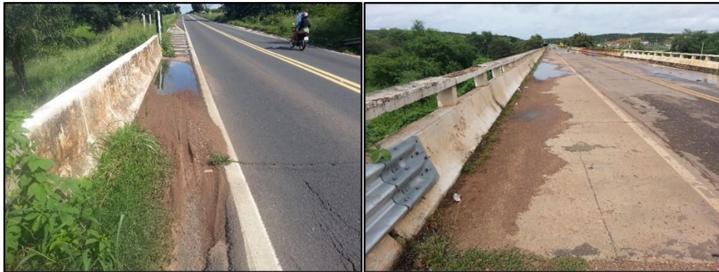
Figura 4.3: Acumulação de sujeira em tabuleiro de OAE.
