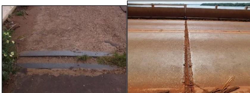
Figura 4.8: Sujeira em juntas de dilatação.
