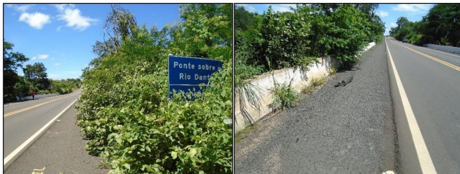
Figura 4.10: Invasão de vegetação em pista de acostamento e rolamento.
