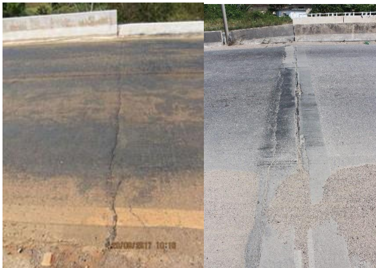
Figura 3.5: Exemplos de registro de Juntas de Dilatação.
