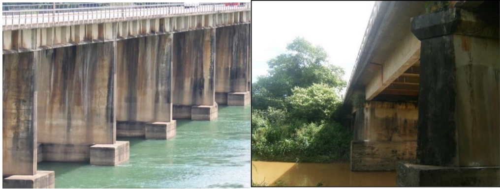
Figura 4.5: Apresentação de manchas de umidade e outros detritos em estrutura de OAE.
