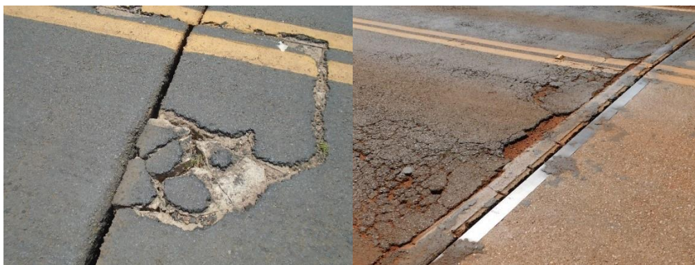
Figura 4.13: Apresentação de danos em juntas de dilatação.
