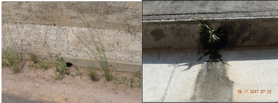
Figura 4.7: Sujeira e/ou entupimento em drenos.
