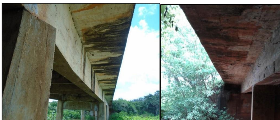
Figura 4.14: Apresentação de manchas de umidade nas extremidades de lajes.
