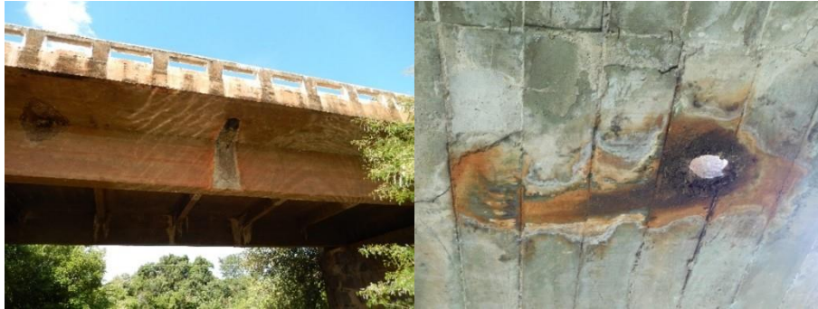
Figura 4.11: Drenos danificados e/ou com comprimento incorreto.
