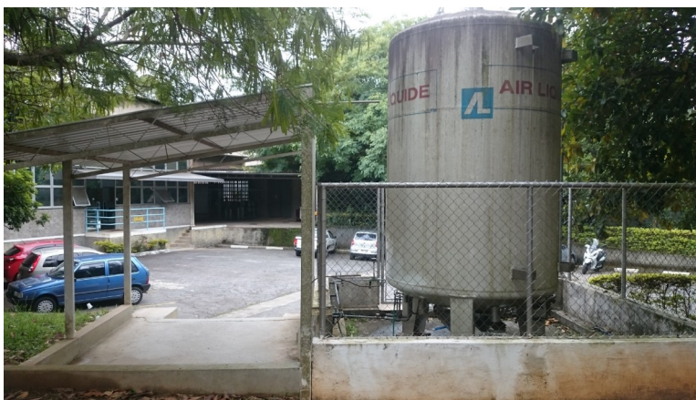
Figura 2: Tanque estacionário com capacidade mínima de 6.000 m 3
