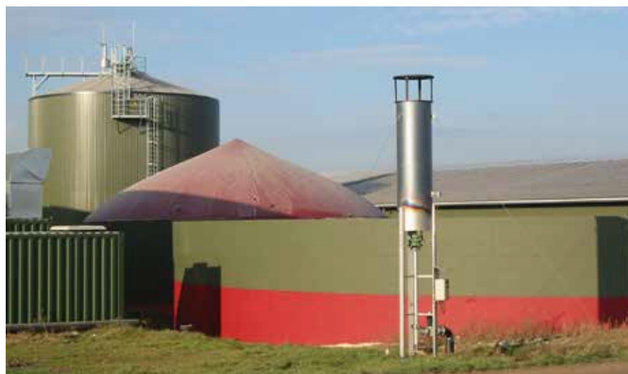
Queimadores liberam o excesso de pressão de forma segura.
