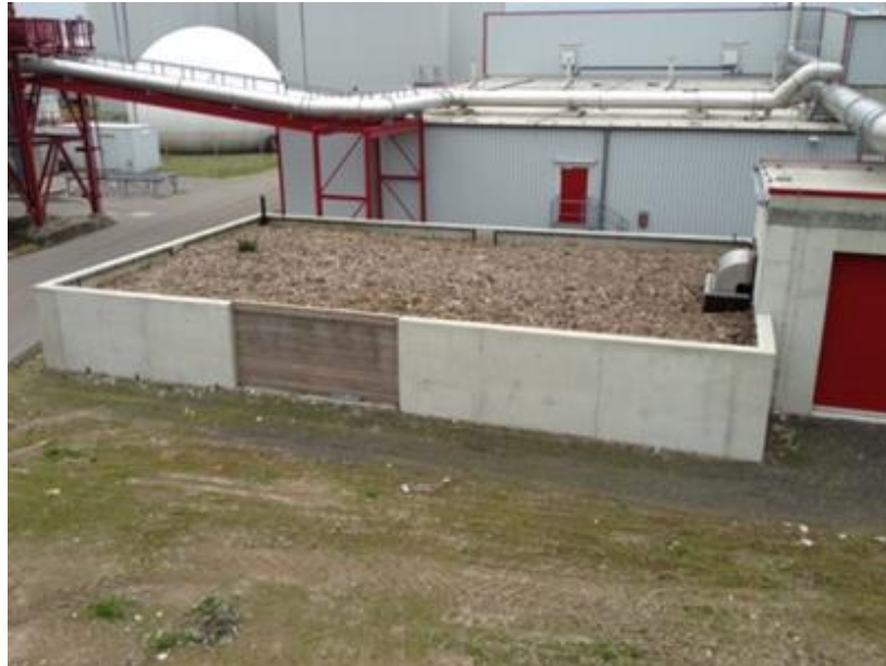
Figura 7 – Biofiltro aberto utilizado no tratamento mecânico-biológico
