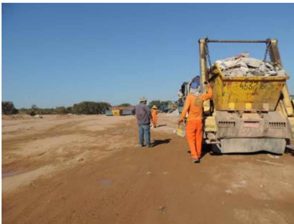
Figura 2 – Avaliação qualitativa dos resíduos depositados no interior da caçamba
