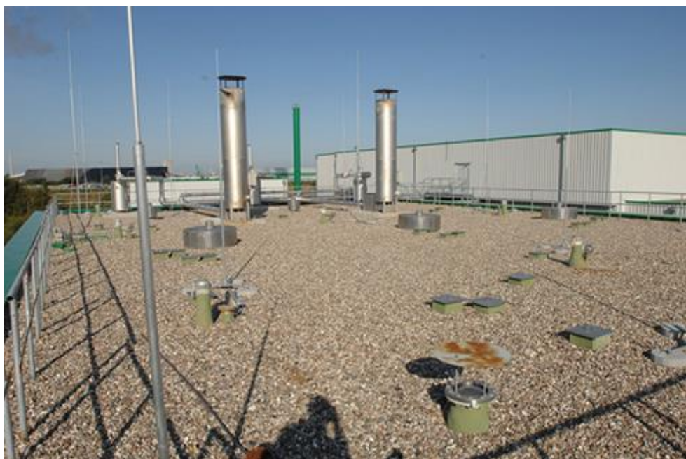
Figura 15 – Sistema queimador fechado para a queima de biogás excedente
