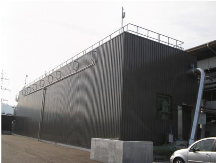
Figura 6 – Fermentador modular para o processamento de 45 t/dia de resíduos orgânicos
