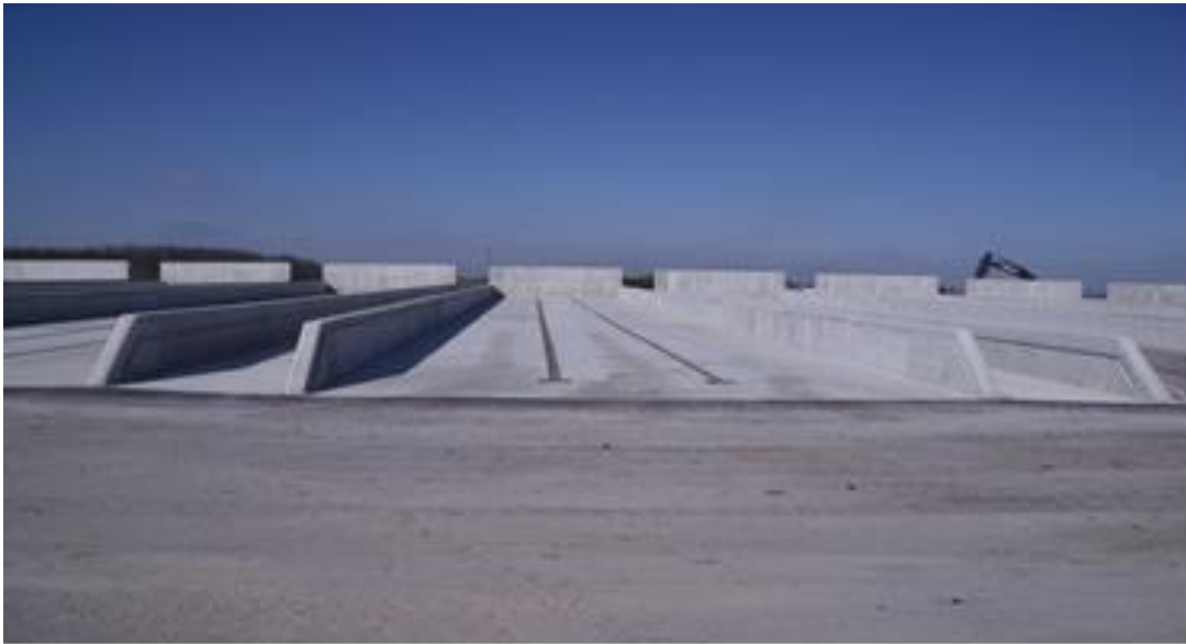
Figura 2 – Reservatório em concreto GORE® Cover
