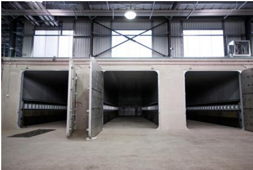
Figura 12 – Túnel de tratamento anaeróbio
