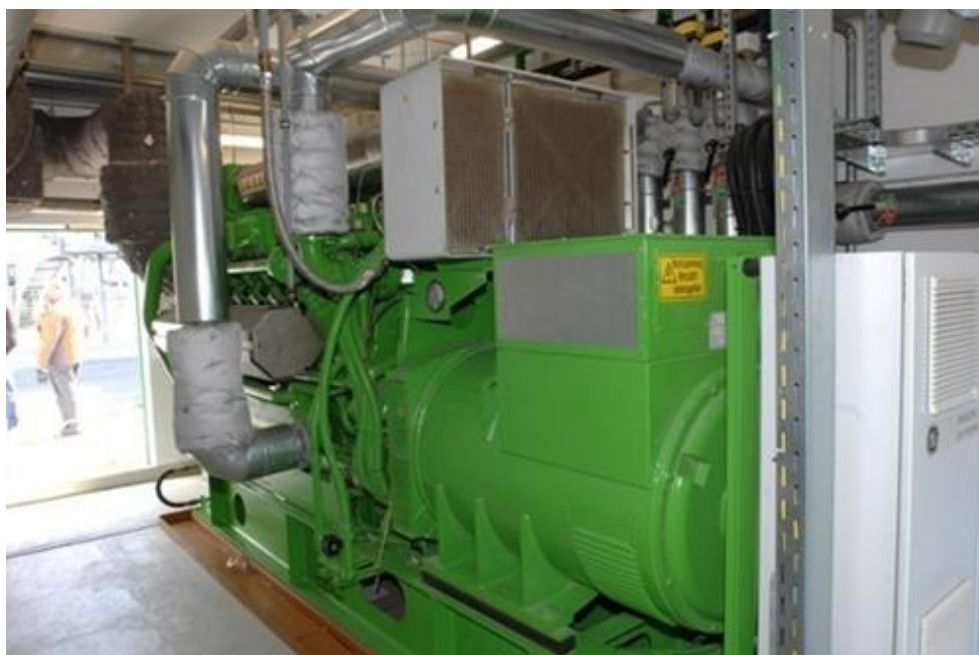
Figura 13 – Motogerador para a combustão do biogás e a geração de energia elétrica
