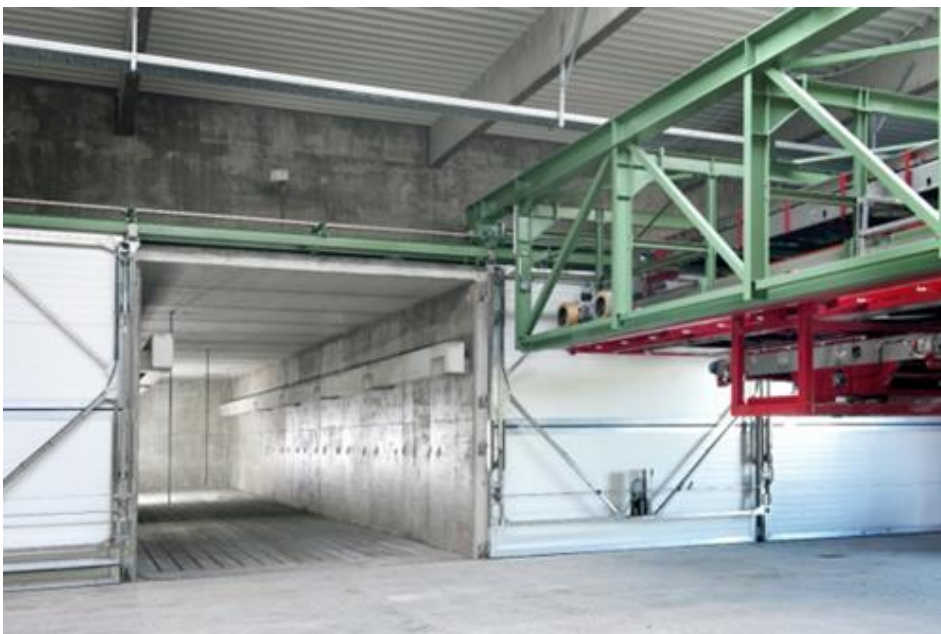
Figura 11 – Túneis de compostagem com sistema de carregamento automatizado
