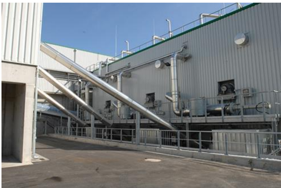
Figura 9 – Sistema de bombeamento do material para o prédio de prensagem
