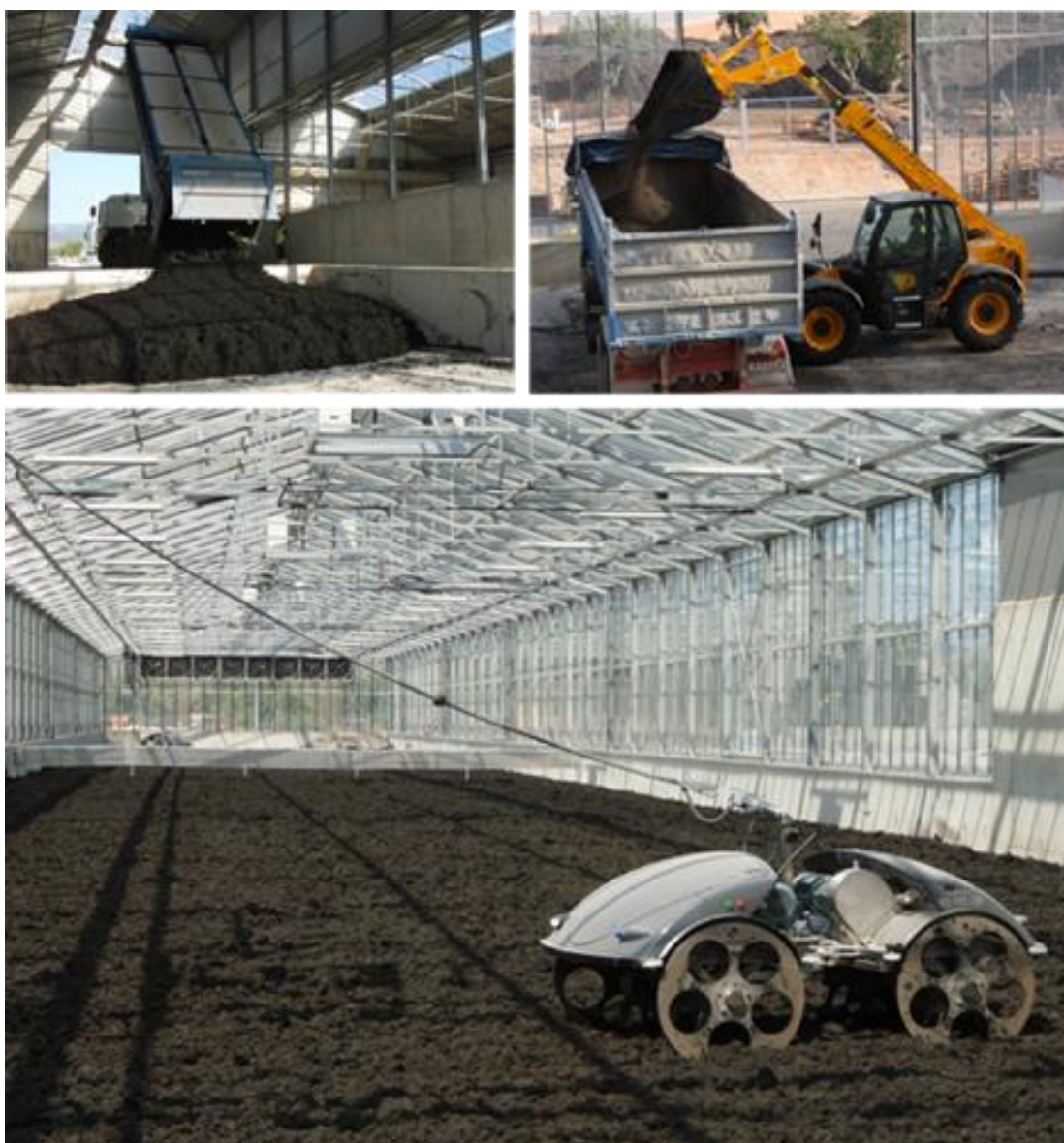
Figura 2 – Recebimento de lodo úmido, secagem e carregamento de lodo seco na planta de secagem solar de Palma de Mallorca
