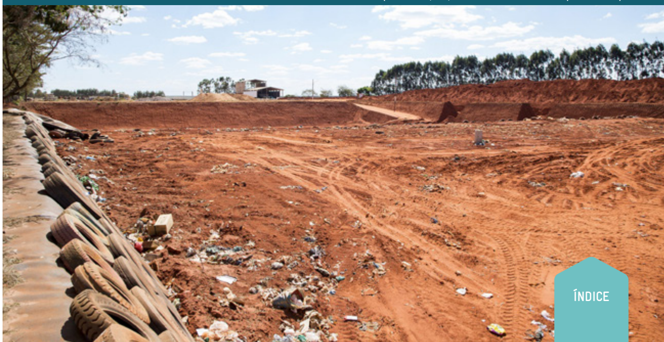
Aterro sanitário de Campo Verde (MT). Foto: Prefeitura Municipal de Campo Verde
