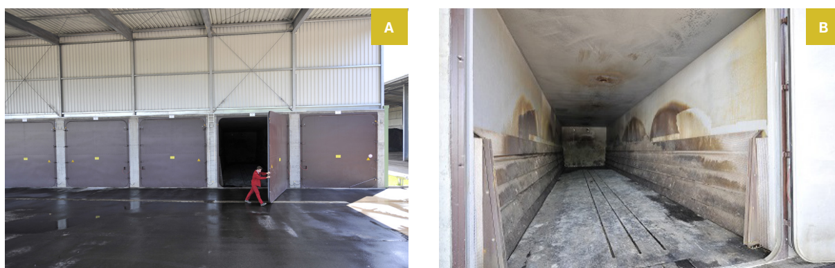
Figura 15: Detalhe da porta dos reatores e sua forma de abertura lateral [A] e imagem do interior do reator, onde pode ser vista a grade e o sistema de injeção de ar [B].
