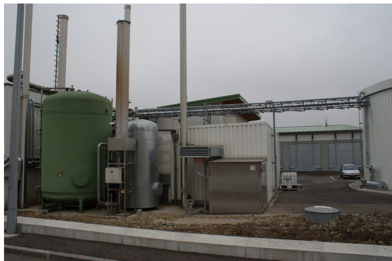
Figura 37: Área de dessulfurização do biogás e cogeração.
