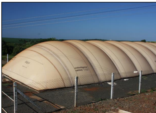
Sistema tipo lagoa coberta Aplicação: resíduos agrícolas
