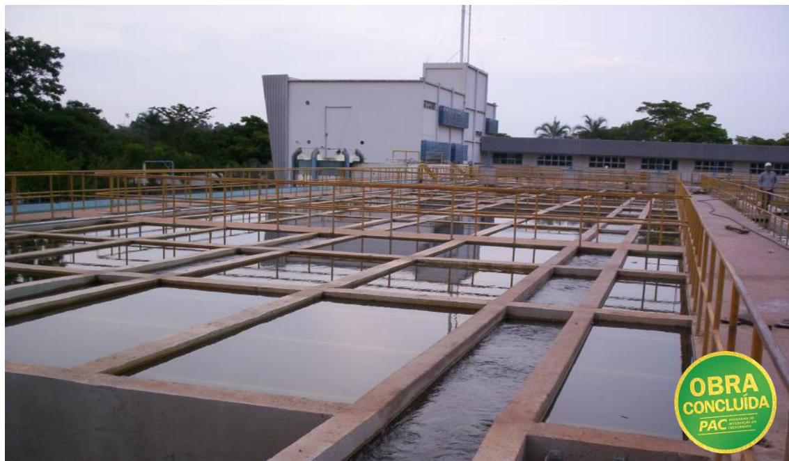
Uberlândia / MG - Ampliação do Sistema de Abastecimento de Água - População beneficiada: 200 mil pessoas. Obra concluída em 2016
