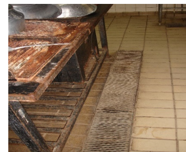
Esgoto nas cozinhas Canindé/CE
