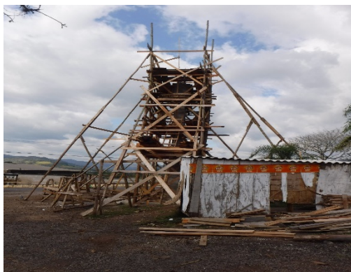
Atraso na execução da obra, Encantado/RS
