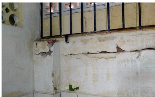
Infiltração na parede da cozinha Ilha de Itamaracá/PE
