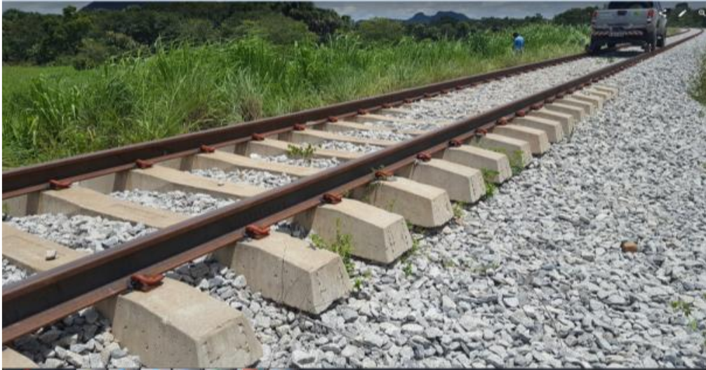
Figura 11 - Espalhamento de brita - falta de ombreira (Fonte: Ação de Controle 201700822)
