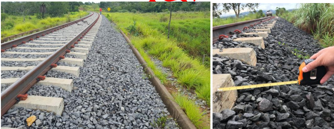
Figura 10 – Insuficiência de Ombreiras (Fonte: Ação de Controle 201700822)
