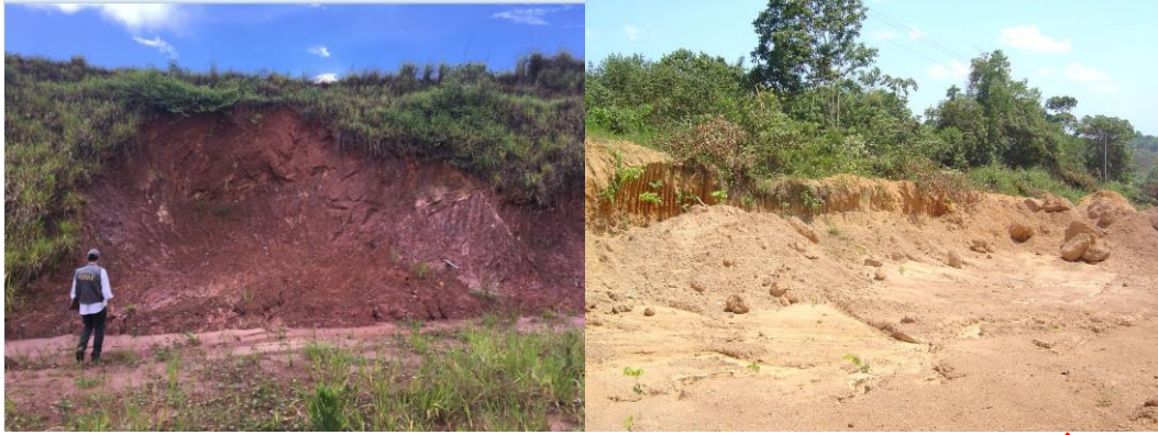
Figura 1 - Talude rompido na ferrovia norte-sul tramo central, caixa de empréstimo não recuperada na BR-163/PA.
