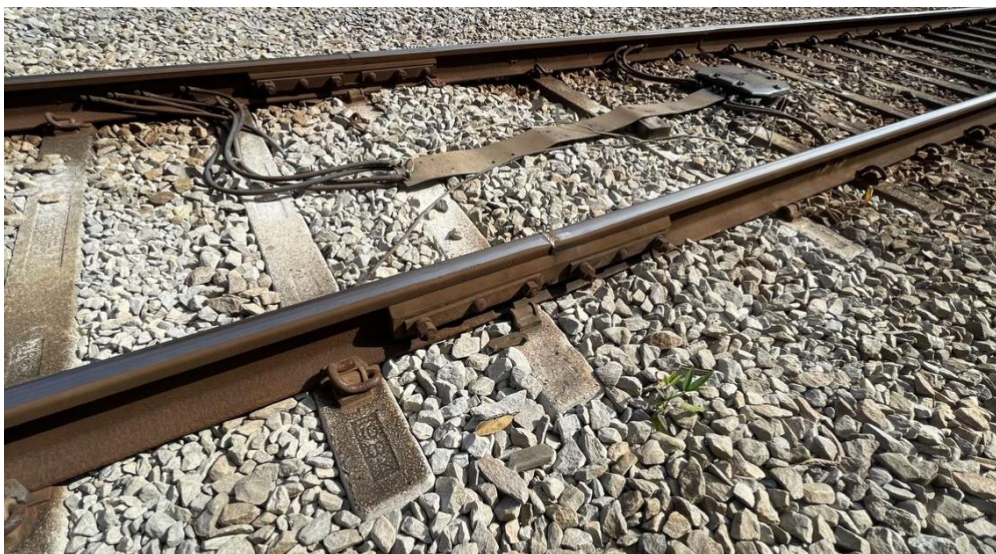
Foto 05: Outra vista de trecho com visível colmatação de lastro
