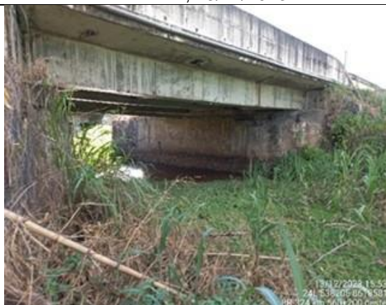
Foto 7-25: Vista geral da passagem de fauna sob a pista oeste. Fonte: VIABAHIA, 13/12/2023.
