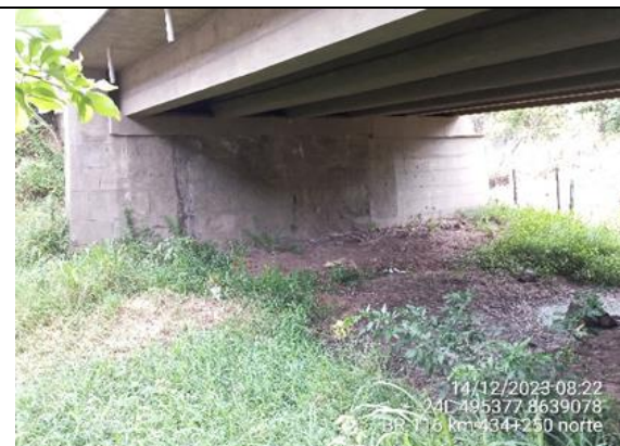
Foto 7-4: Detalhe evidenciando área seca na passagem de fauna para uso pelos animais - pista norte. Fonte: VIABAHIA, 14/12/2023.
