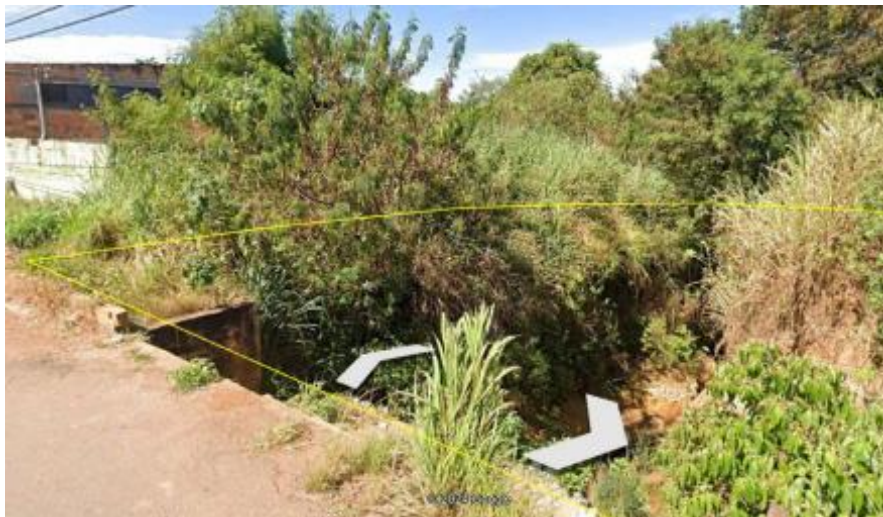
Figura 24: Erosão saída drenagem fora da faixa de domínio (antes-fev/24)
