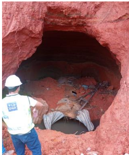
Figura 21: Rompimento da drenagem e aterro na plataforma da rodovia (antes-fev/24)
