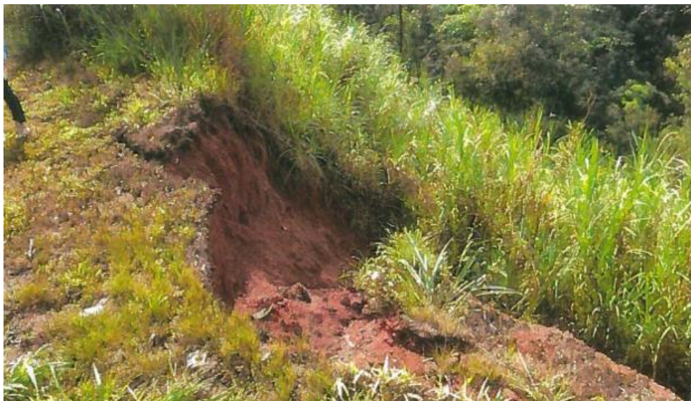
Figura 20: Vista do escorregamento de talude próximo a faixa de rolamento (antes-out/23)
