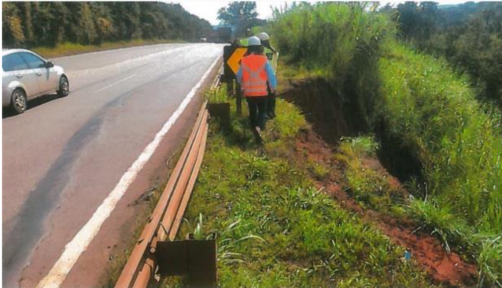
Figura 19: Vista do escorregamento de talude próximo a faixa de rolamento (antes-out/23)
