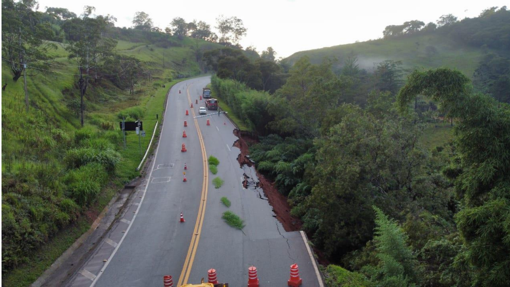
Figura 16: Vista do escorregamento de talude e rompimento da faixa de rolamento (antes-jan/23)
