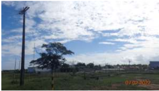
Foto 14: Poste ainda instalado no local.
