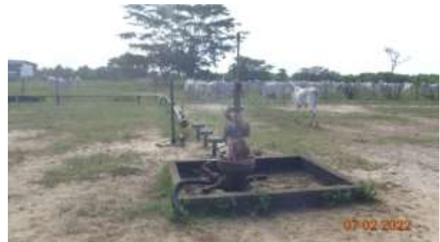
Foto 13: Nesta imagem podem ser observados o antepoço, o equipamento de elevação e parte da linha de escoamento ainda instalados.
