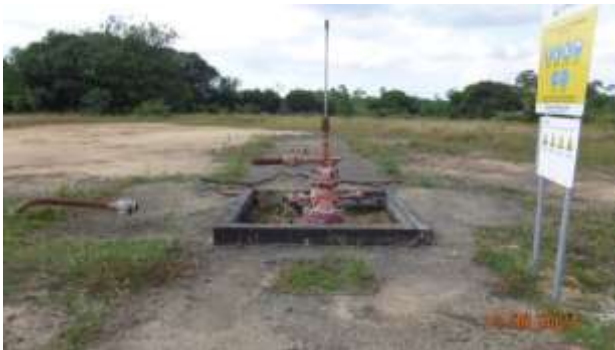
Figura 4: Equipamentos de superf cie 1-RIB-1-ES
