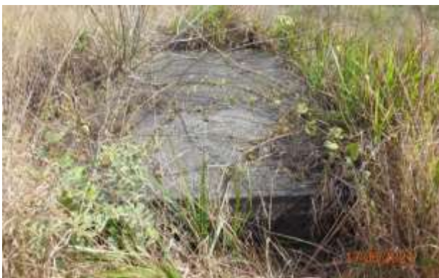
Figura 6: Equipamentos de superf cie (fossa) 1-RIB-1-ES
