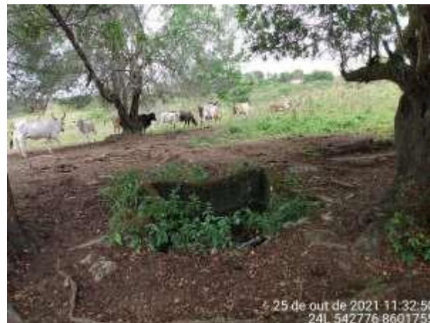
Fig. 29: Restos de piso de concreto e ante-poço aberto na área de pastagem.
