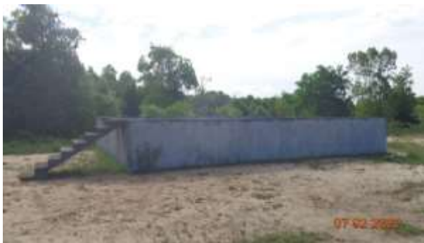
Foto 7: Detalhe da bacia de contenção existente no local.
