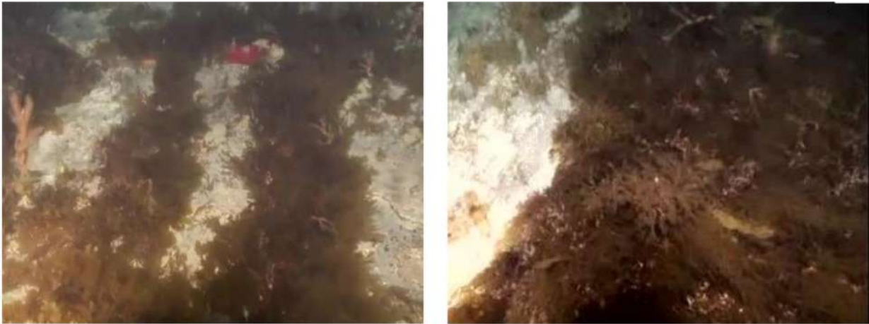
Figura 3.3-IX - Ocorrência de algas verdes e pardas em trecho gasoduto 4" PBIQ-01/PPE1-A/UTPF
