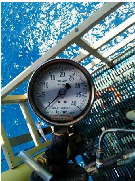
Figura 5.3.1-I – Registro de pressão na cabeça do poço 1-RNS-134, em 26/09/2021.
