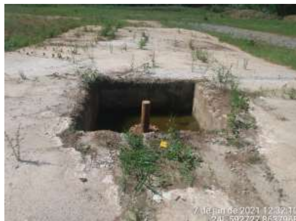
Fig 2: Base do poço consta de piso de concreto, equipamento estrutural e ante poço aberto com acúmulo de água
