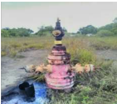
Fig. 05 A: Poço 1-DA-1-BA - Equipamentos de Superfície e base de concreto
