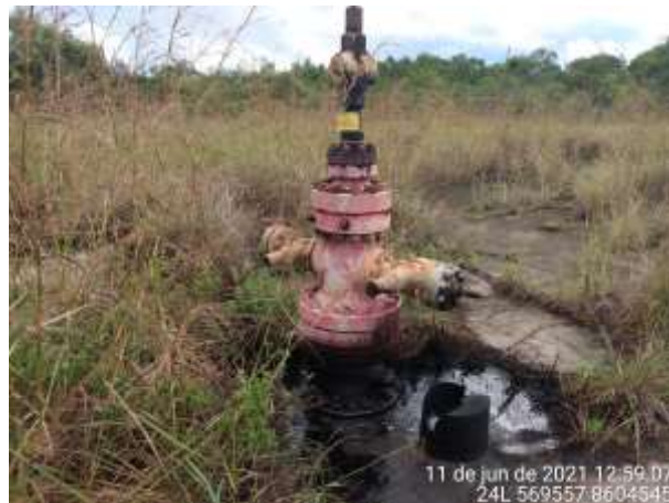
Fig. 02: Equipamento estrutural de superfície apresentando vazamento de resíduo oleoso na base do poço
