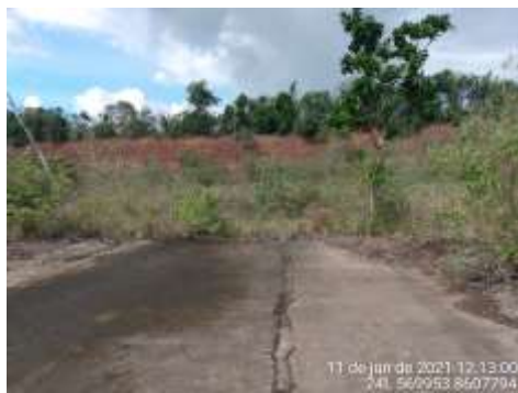
Fig. 03: A base do poço apresenta piso de concreto e vegetação de gramíneas e arbustiva.
