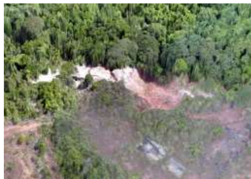
Fig. 04: Talude a jusante apresentando processo erosivo em avançado estágio de degradação ambiental.
