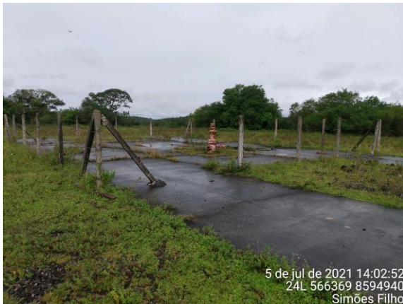
Foto 16: Área do poço com base de concreto, estrutura operacional e cerca de proteção.
