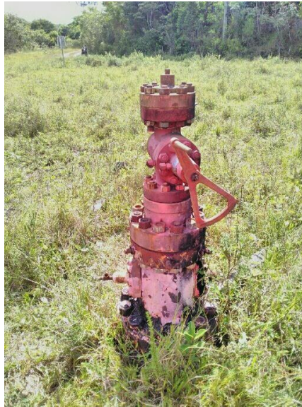
Foto 19: Poço 1-CA-2-BA: Equipamentos de Superfície e Base de concreto.
