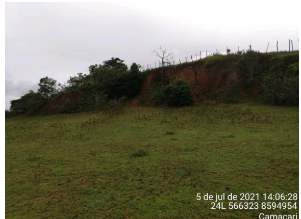
Foto 17: Ocorre processos erosivos na face do talude a montante do poço.
