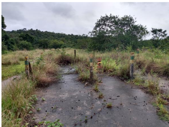
Foto 14: Área do poço com base de concreto, estrutura operacional e cerca de proteção danificada.
