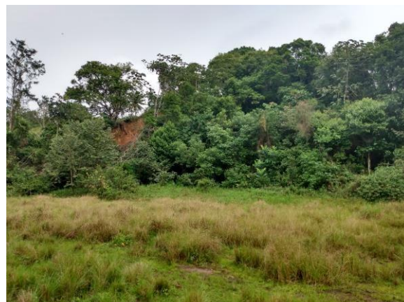
Foto 15: Talude a montante do poço apresenta-se erosão laminar em uma das suas extremidades, a oeste do poço.
