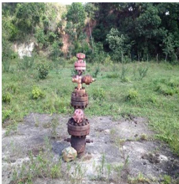
Foto 20: Poço 3-CA-3-BA: Equipamentos de Superfície e Base de concreto
