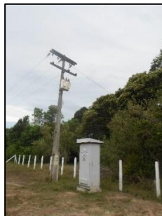
Foto 21: Poste de energia e Abrigo do Conversor de Frequência
