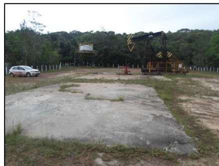
Foto 18: Vista da base do poço, Unidade de Bombeio Mecânico e Tanque TQ-310G00-01
