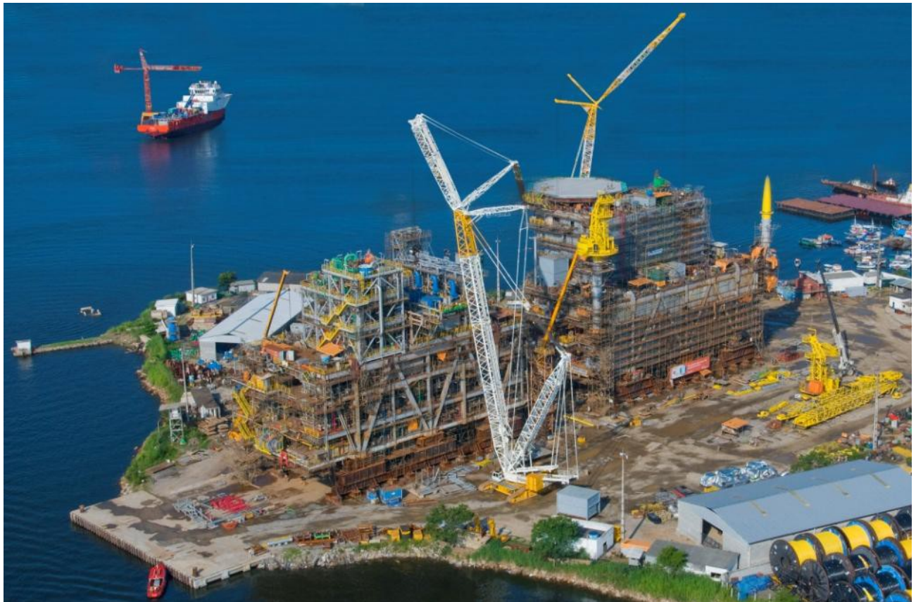
Figura 5 – Integração dos Módulos M01/M04/M05 e M02/M03 da Plataforma PMXL-1 em construção no canteiro na Ilha da Conceição do Estaleiro Mauá
