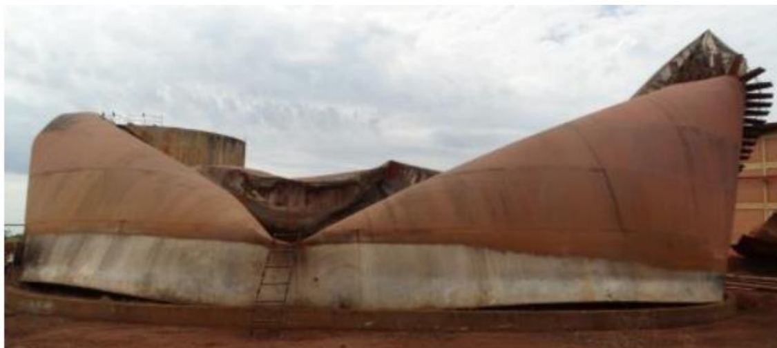
Figura 6 – TQ-03 colapsado após encerramento das atividades de rescaldo.
