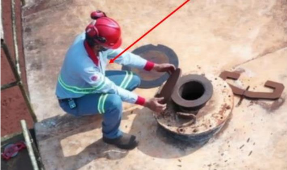
Figura 23 – Escotilha de medição do tanque de armazenamento de etanol nº 02.
