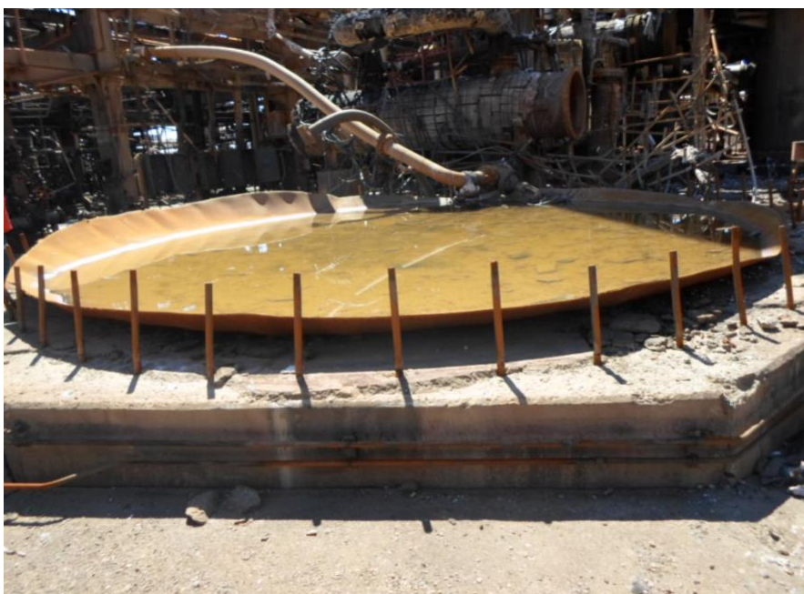
Foto 2: Base do tanque TQ-68301 após explosão.
