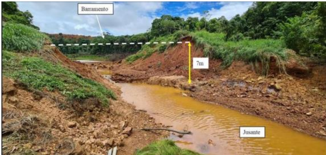
Figura 12: Situação do barramento após o galgamento.
