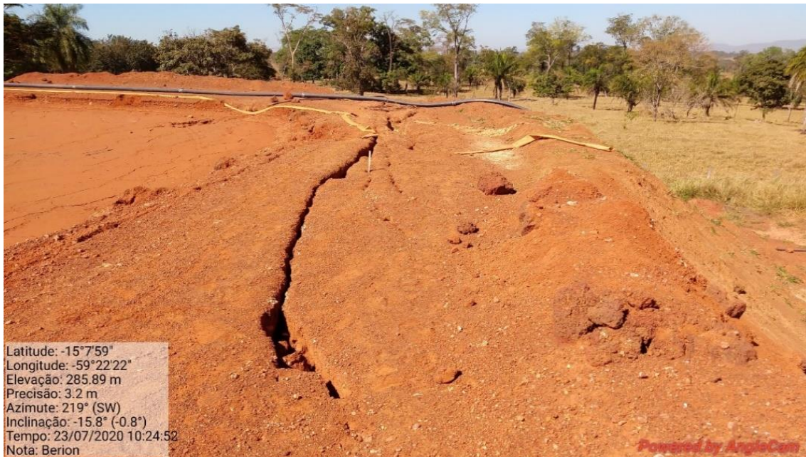
Figura 14: trincas encontradas na crista da barragem Berion e borda livre insuficiente.
