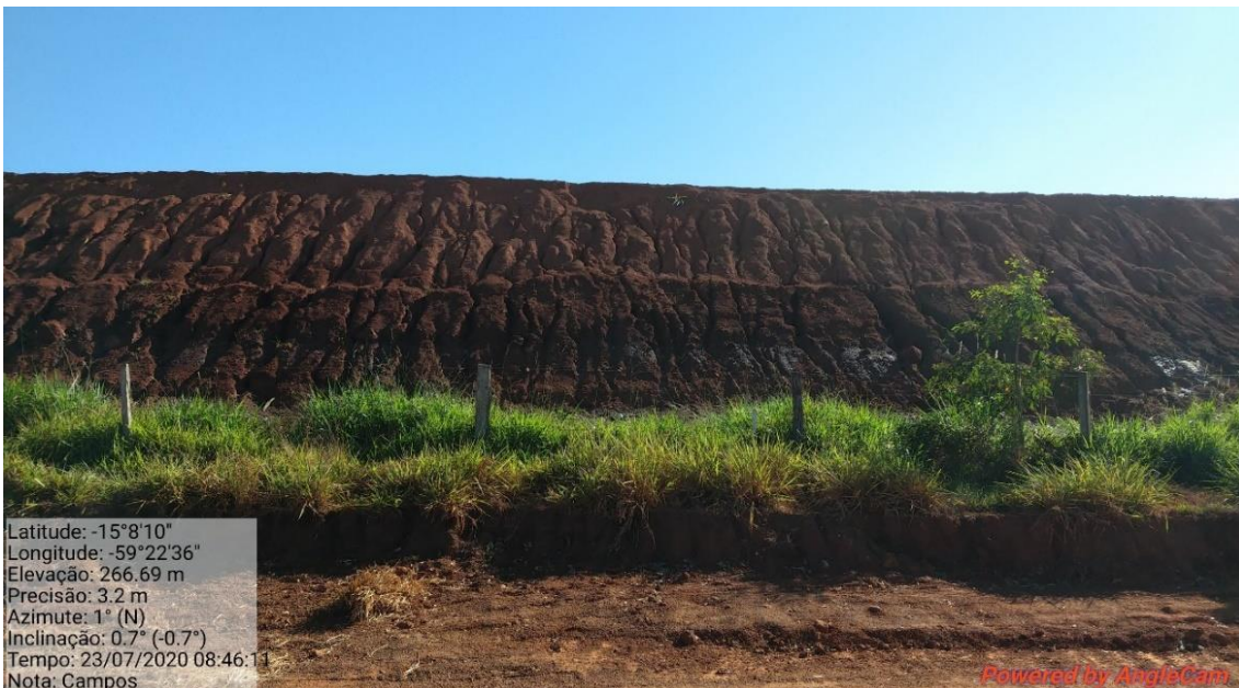
Figura 13: talude de jusante da barragem Campos com erosões superficiais e destaque para a linha de saturação
