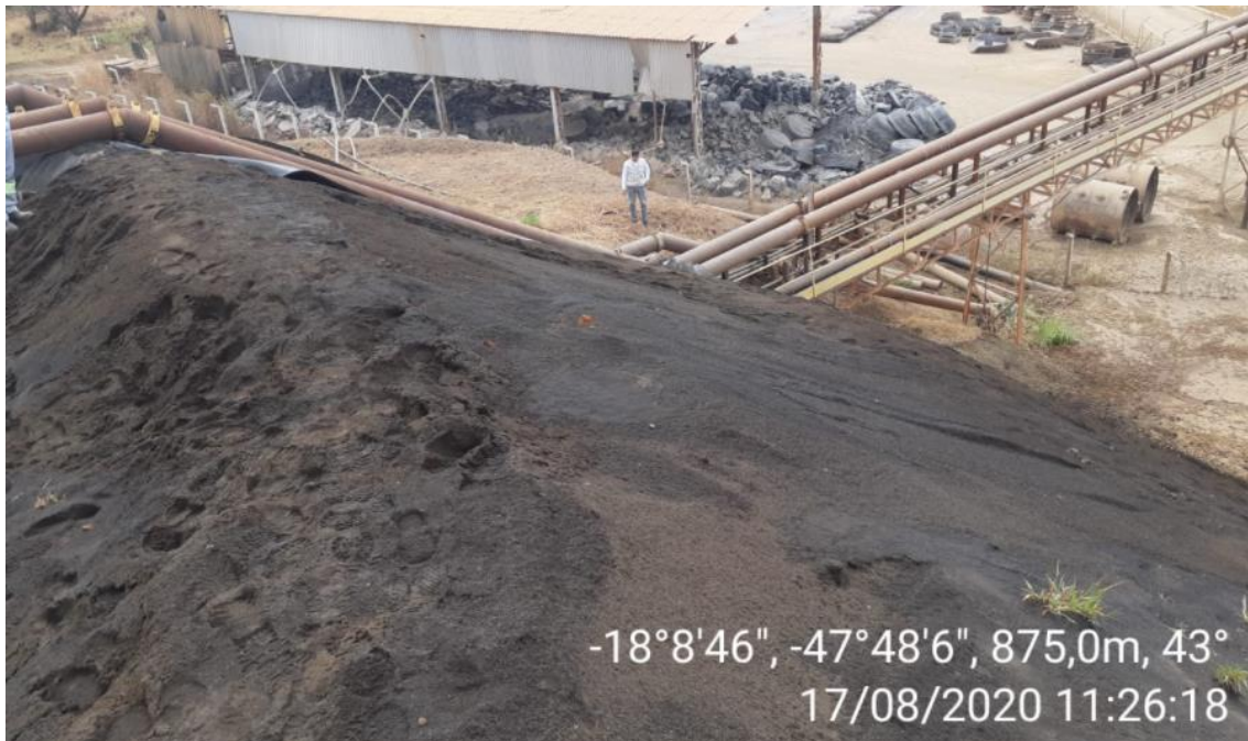
Figura 19: vista superior da área reconformada indicando recobrimento da erosão
