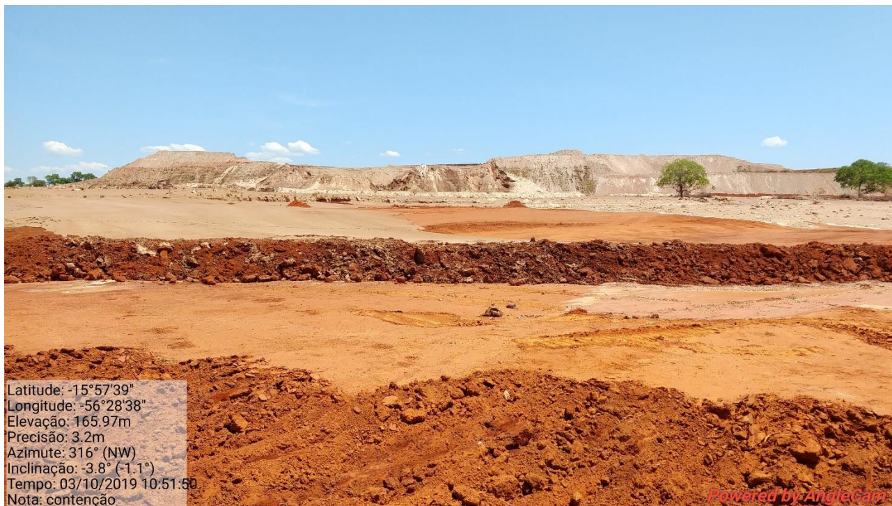
Figura 14 – Rompimento da barragem TB01 em Nossa Senhora do Livramento – MT, com espalhamento de rejeitos nas proximidades da barragem.
