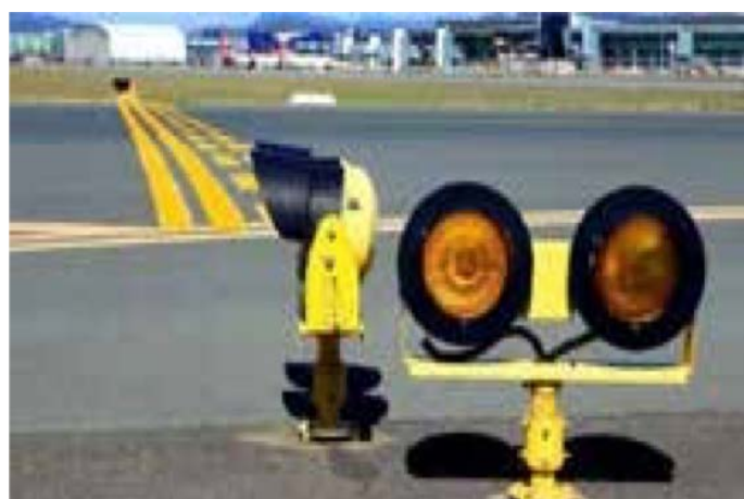
Figura 12 – Luzes de proteção de pista de pouso e decolagem.
