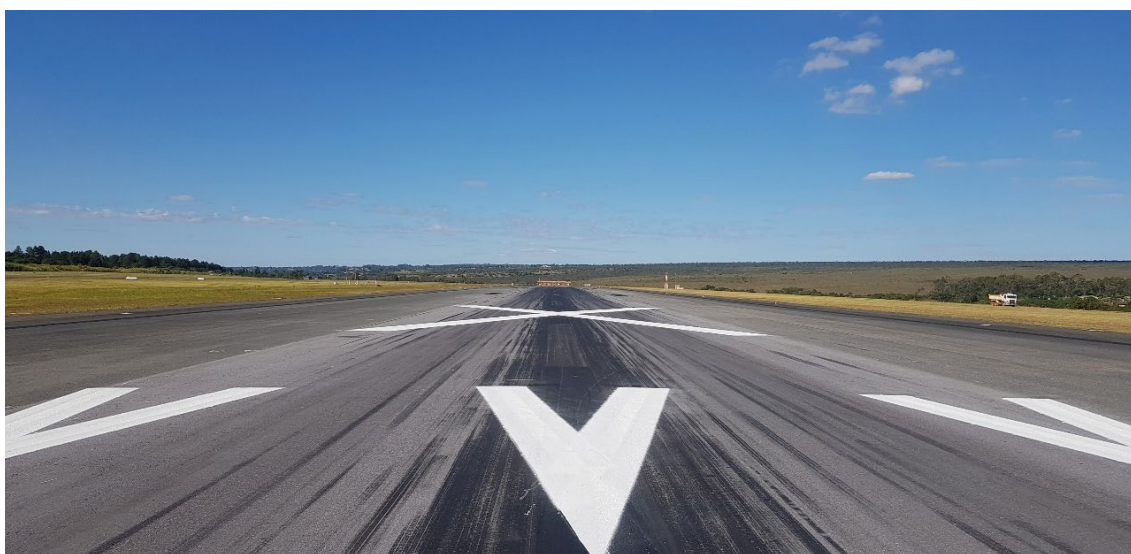
Figura 32 – Trecho anterior à cabeceira deslocada fechado ao tráfego
